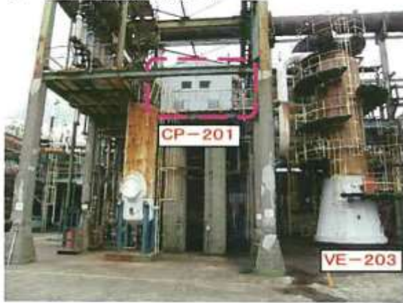
CP-201設置状況(南側から)
