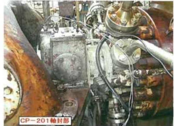
ガス漏洩場所
