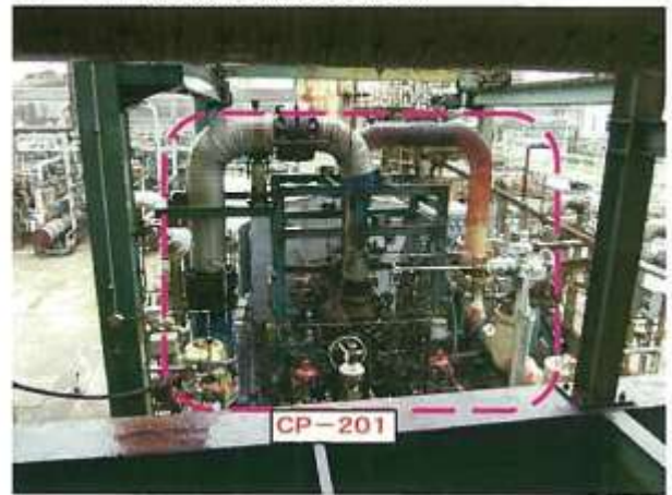
CP-201設置状況(北側ラック上から)
