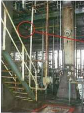
潤滑油漏洩場所(南東から)
