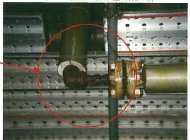
潤滑油漏洩位置(南側から)
