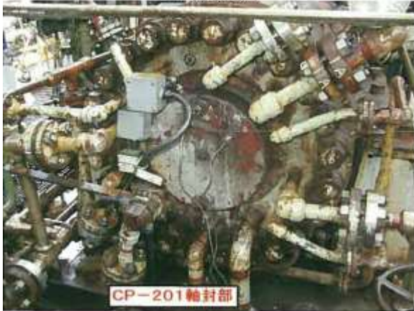
ガス漏洩場所
