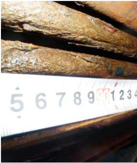
写真 5 腐食減肉状況(チューブシートから約 900mm、#24-5)
