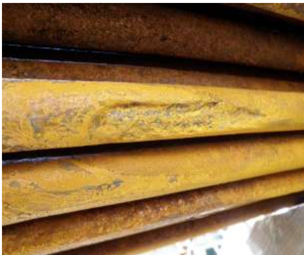
写真4 腐食減肉状況(#24-2)
