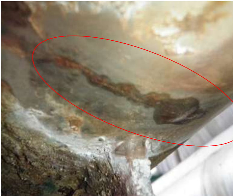
写真 4 漏えい部の拡大
