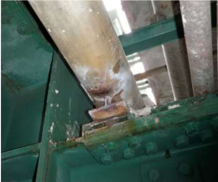
写真 1 漏えい部の状況
