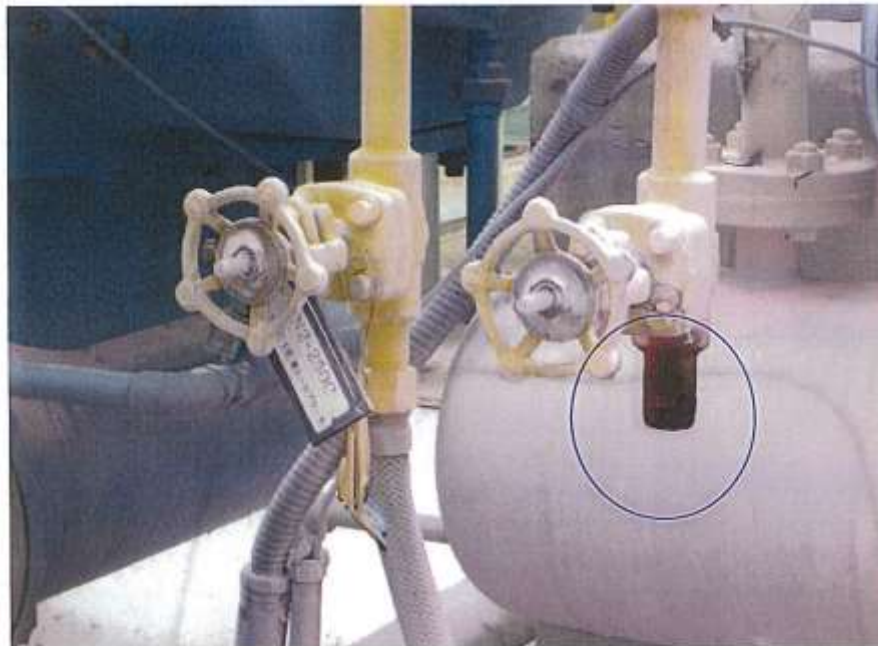
1 段側窒素シールガスブロー弁開状態で、閉止していたコルク栓は落下して消火剤に埋もれて発見、ワイヤーは切れていた コルク栓は焦げていない
