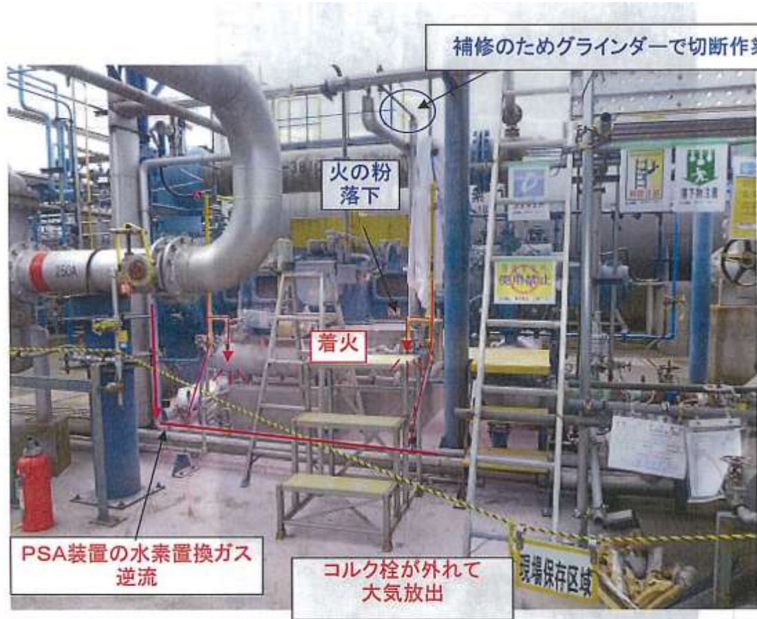
グラインダー切断工事と窒素シールガスブロー弁の火災状態
