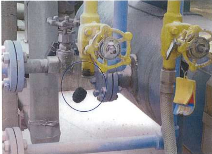
2 段側窒素シールガスブロー弁開状態で、閉止していたコルク栓は外れていた状態でコルク栓は焦げていた
