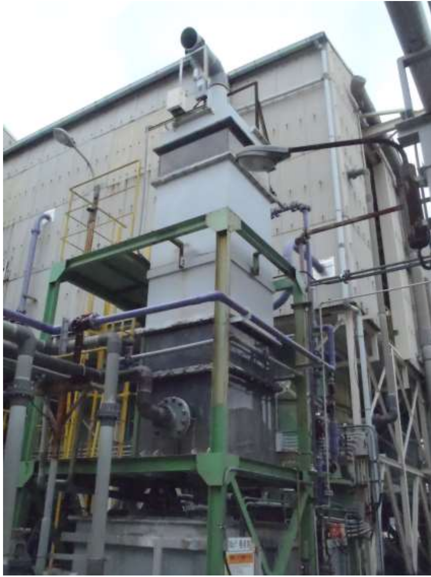
写真2 除害装置の排気口
