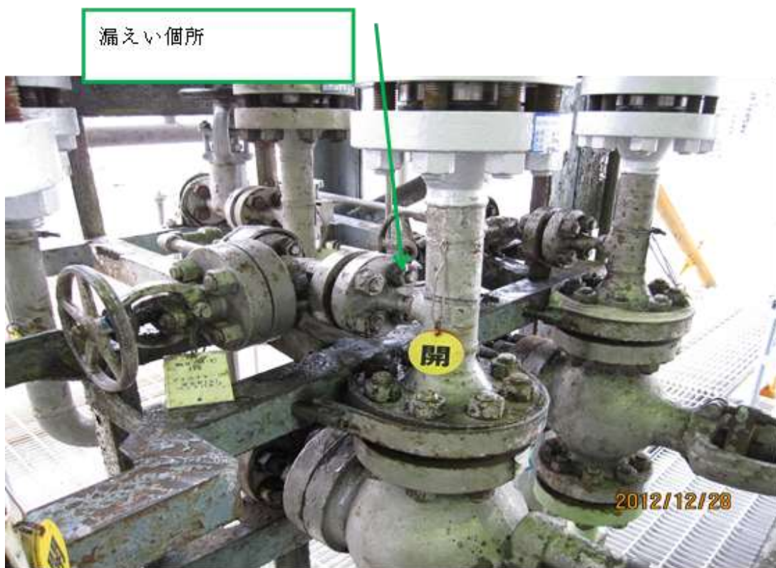
写真-1 エチレン供給圧縮機1段吐出安全弁ベントバルブ入口配管
