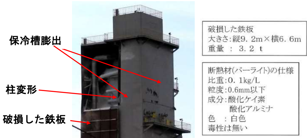
図2 保冷槽損傷状況
