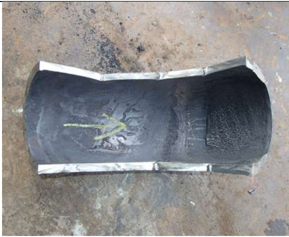
写真 5 エルボ内面の状況
