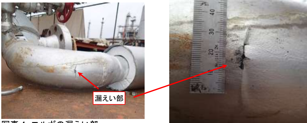
写真 4 エルボの漏えい部
