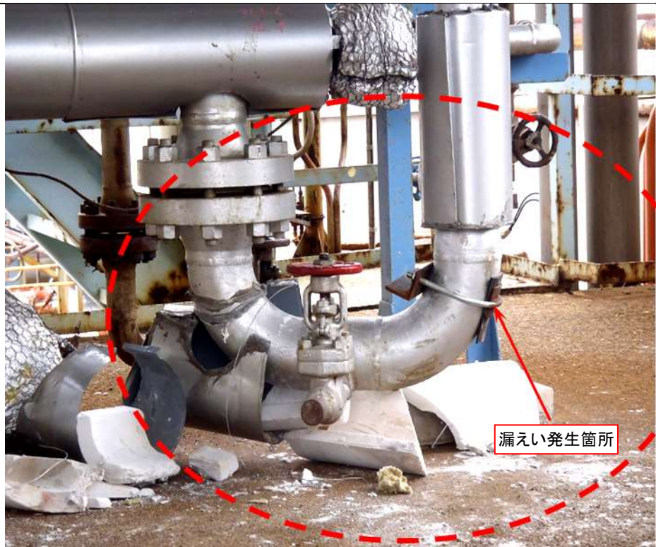
写真 2 漏えい発生部位の状況
