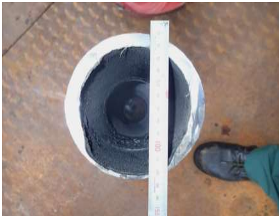
写真 7 エルボ下流のレデューサーの減肉状況
