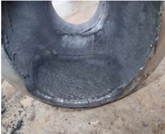
写真 8 レデューサー内面の状況
