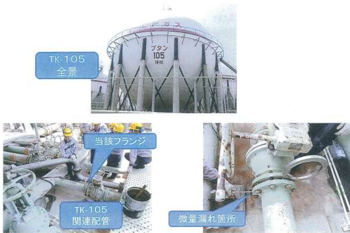
図-3 漏えい箇所
