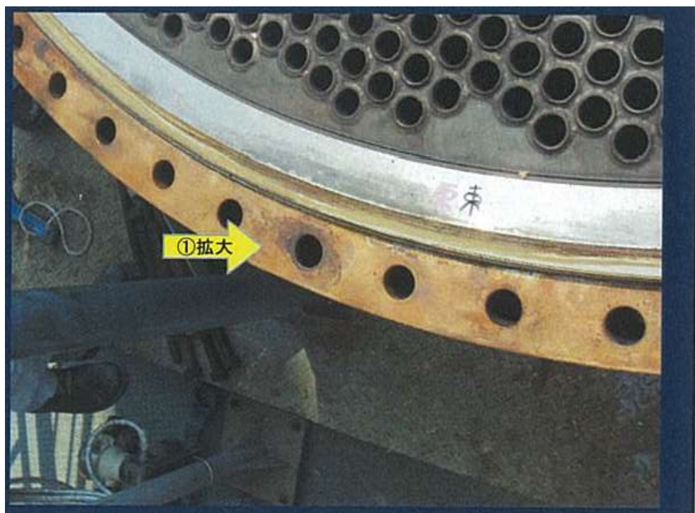
写真-3 漏えい箇所(推定)
