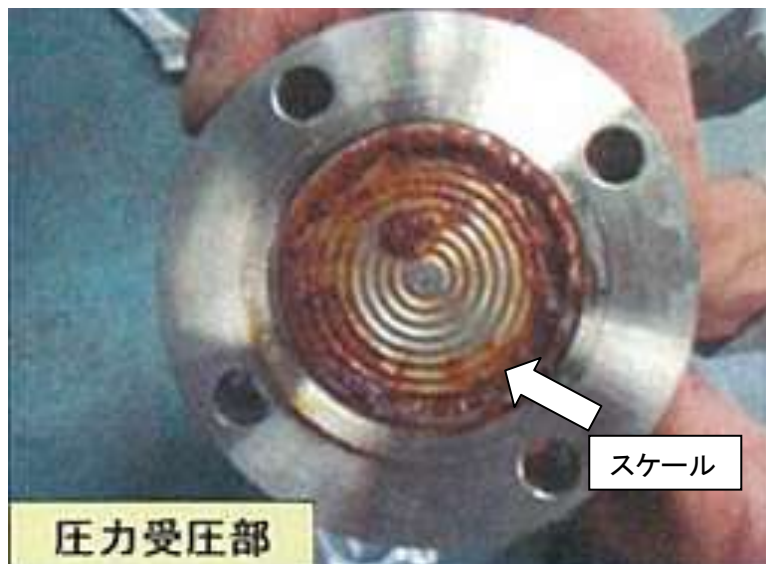
写真-2 塔頂圧力計(GPIC2205)の受圧部のスケール
