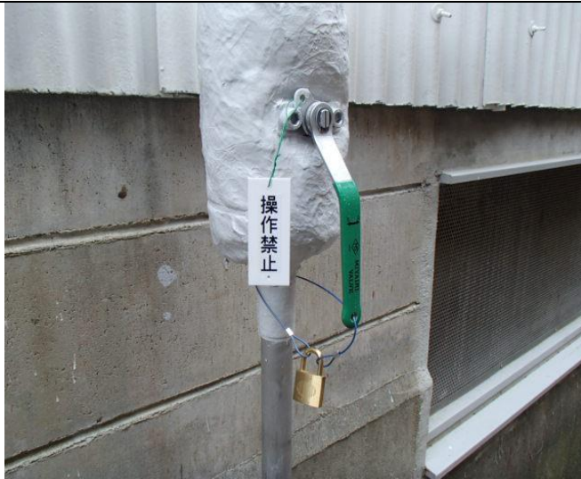
写真2 ベント配管放出元弁の施錠と操作禁止札 (現在、ベント配管の全ての弁は撤去済み)
