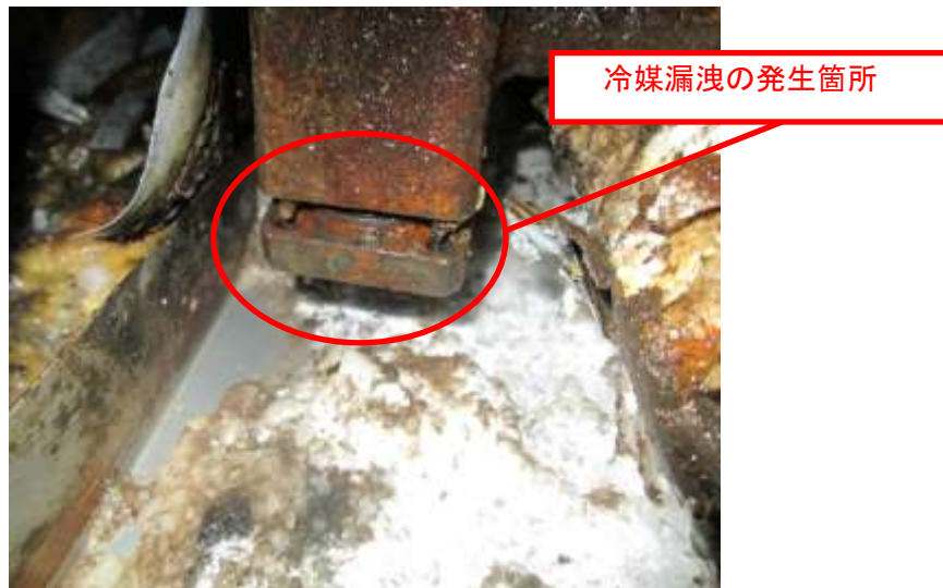
図2 冷媒漏えいが発生したストレーナーカバー部
