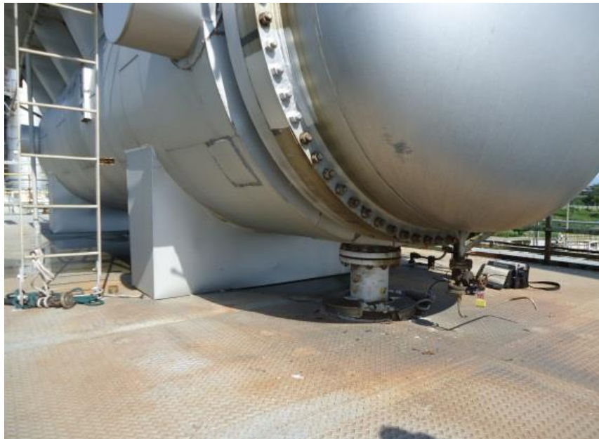
写真1 凝縮器と降液配管
