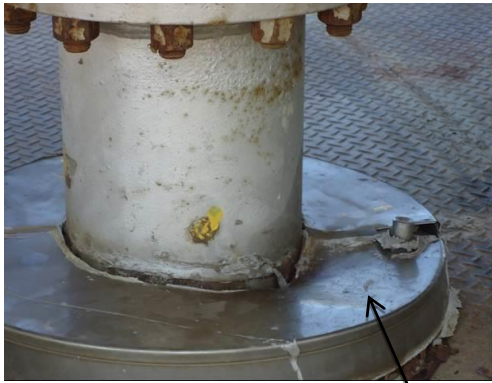
写真2 床上側からの外観 (事故当時)
