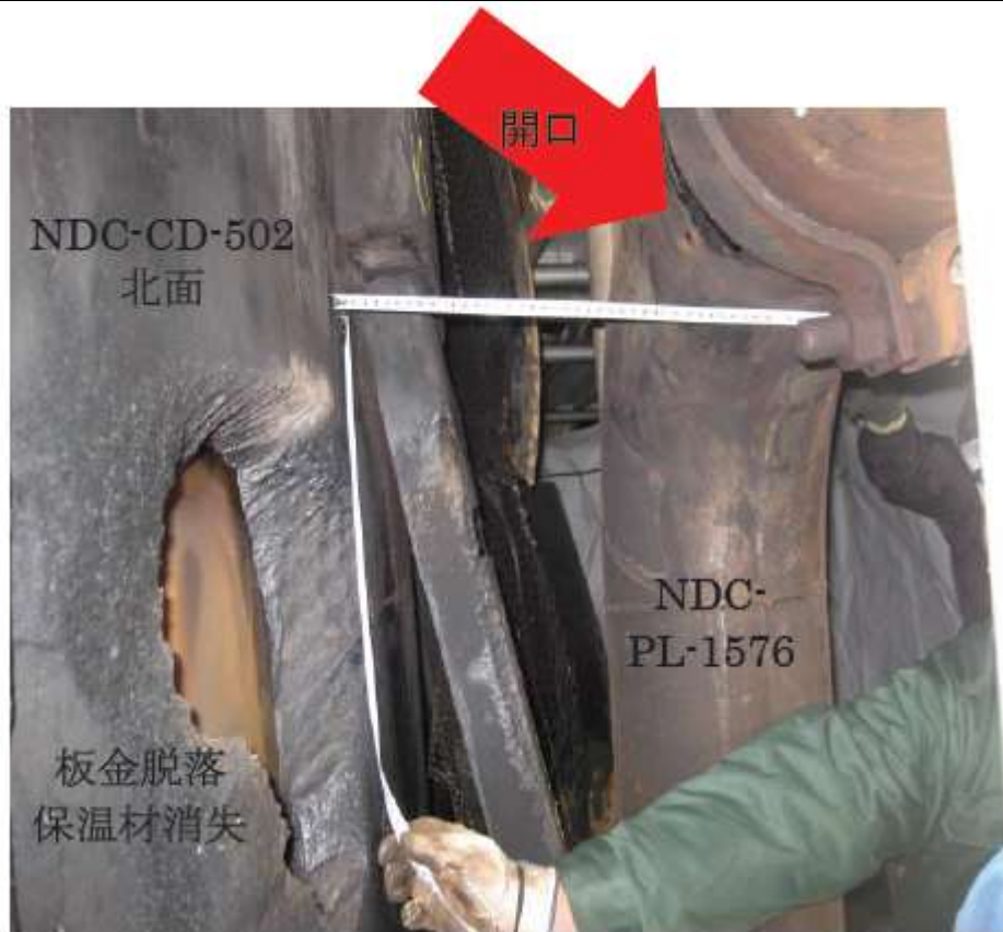
図8 配管開口部と保温材焼損部の位置関係
