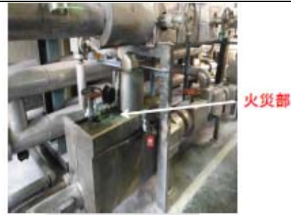
火災後（保温解体前）
