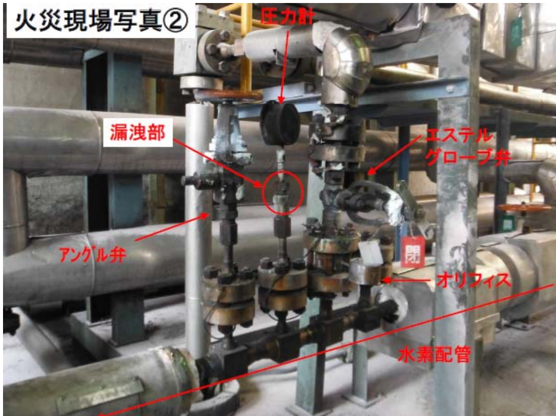
図2 火災後の状況
