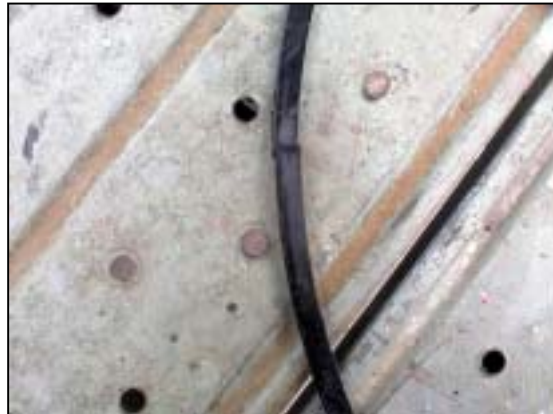
ガスケットの割れ
