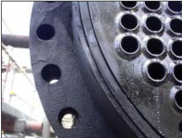
ガスケットの割れ発生部
