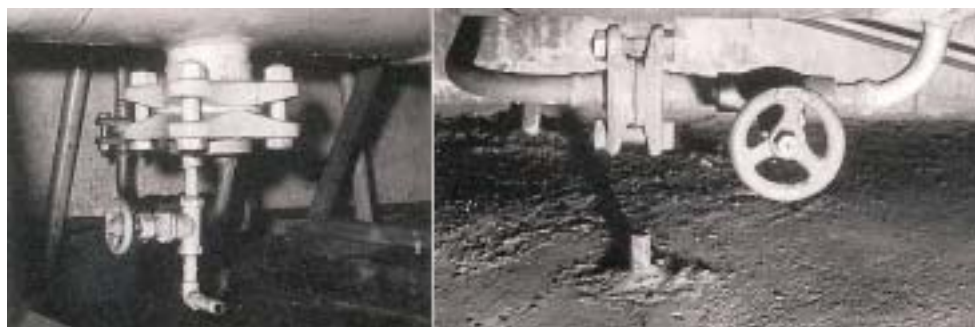
写真2 アンモニア設備のフランジ継手の例(左:4本ボルト、右:2本ボルト)
