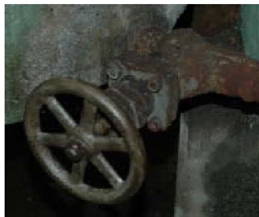
写真 1 アンモニアが漏えいし、死亡事故を起こしたドレン弁
