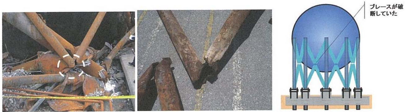
図5-4 364番タンクのブレース破断状況
