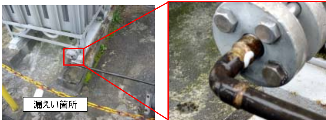
写真2 送ガス/送液ラインの事例(ろう付け部)
