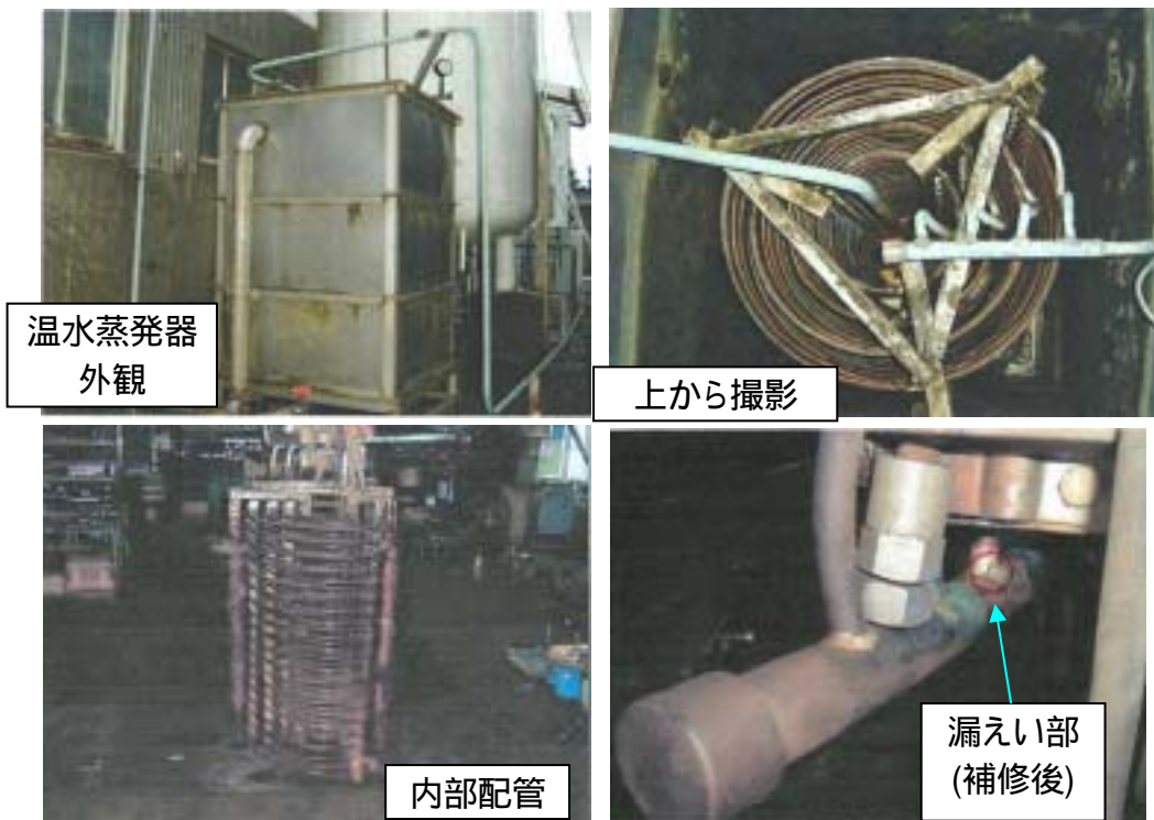
写真 7 送ガス蒸発器の事例 :温水蒸発器のヘッダー
