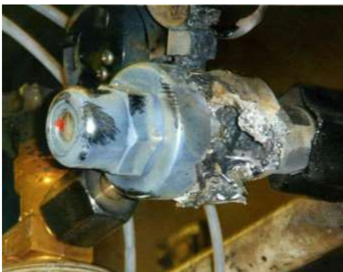
写真 圧力調整器の事故例（事業所提供）
