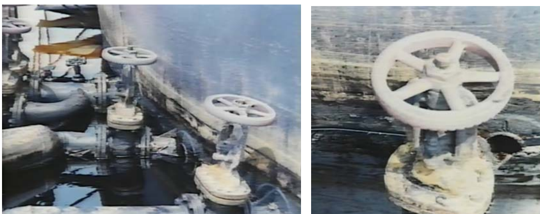
写真 17 ガソリタンク#33 の鋳鉄元バルブとノズルの損傷状況(*2)
