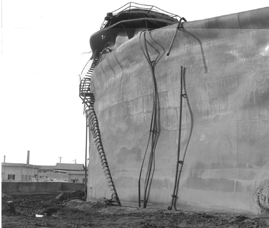
写真 16 原油タンク#1103 の側板の状況
