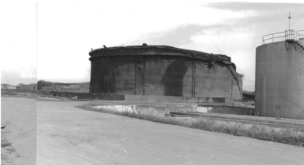
写真 15 地上からみた原油タンク#1103 の状況
