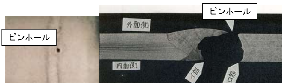
写真 内面腐食に起因した溶接部のピンホール
