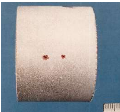
写真 配管表面に貫通したピンホールの例
