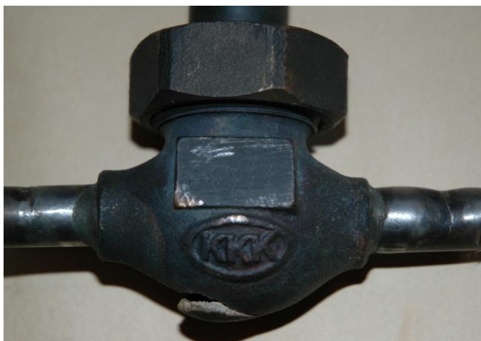
写真3 液封で破裂した例（閉止弁、2006年1月発生）
