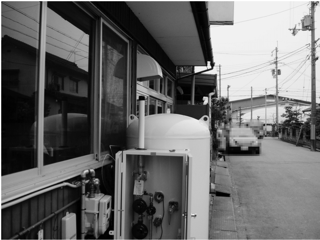
バルク貯槽設置状況
